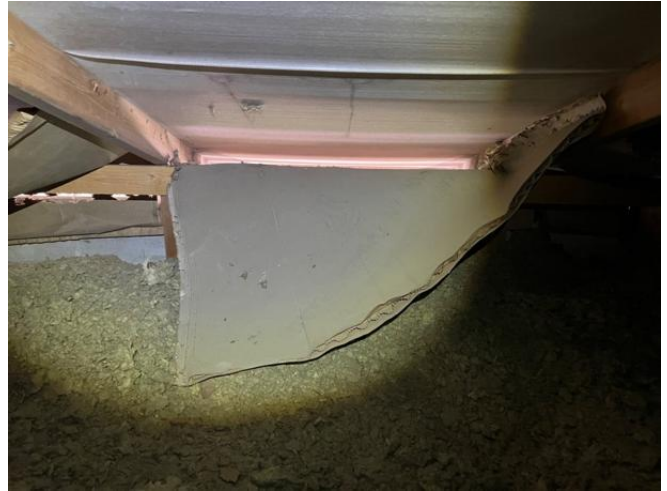
Osa tuulenojhauslevyistä irronnut. Suositellaan kiinnittämään ja tarvittaessa uusimaan muun työn yhteydessä.
