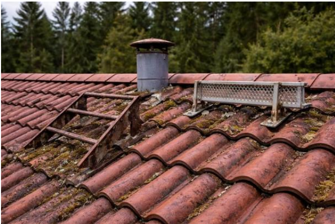
Kattosillat ja lapetikkaat huonossa kunnossa. Suositellaan uusimaan muun työn yhteydessä.
