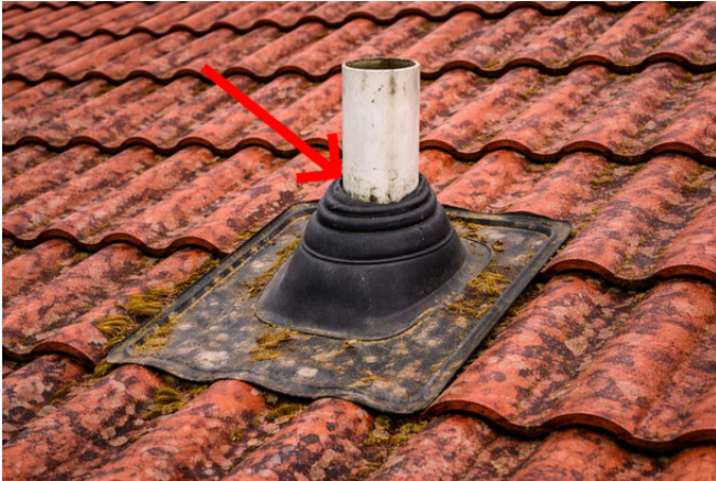
Tuuletusputken läpivienti epätiivis. Suositellaan massaamaan muun työn yhteydessä.
